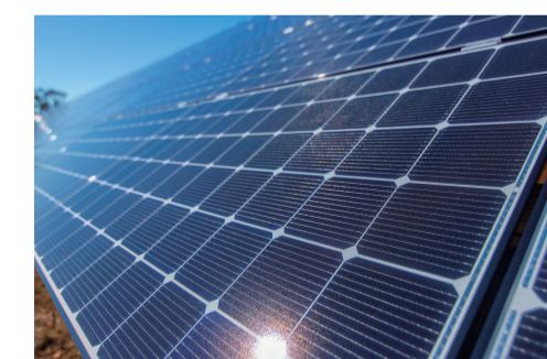
屋頂使用太陽能板排列
